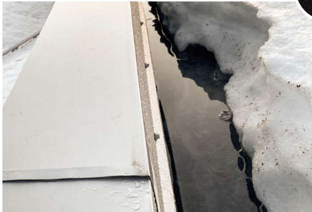
Taksluket har blitt tildekket. Vann og is samler seg på taket.
